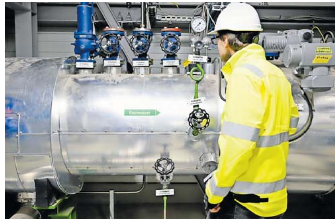
Wärmepumpen in Flüssen sind viel effizienter als Luft-Wärmepumpen und haben auch ökologische Vorteile, weil sie das Flusswasser leicht abkühlen. FOTO: DPA
