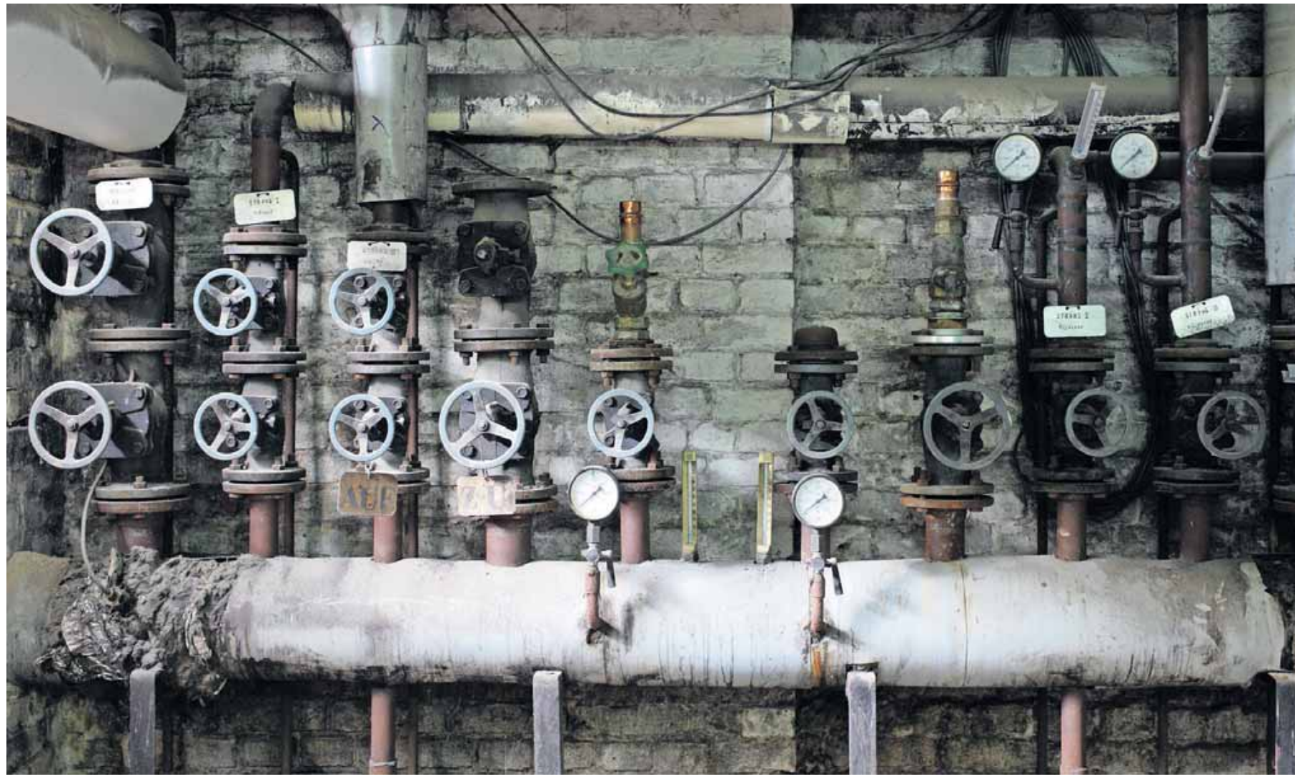
Jede achte Heizung ist schon länger als 25 Jahre in Betrieb. Viele der alten Anlagen dürfen dennoch weiterlaufen.
