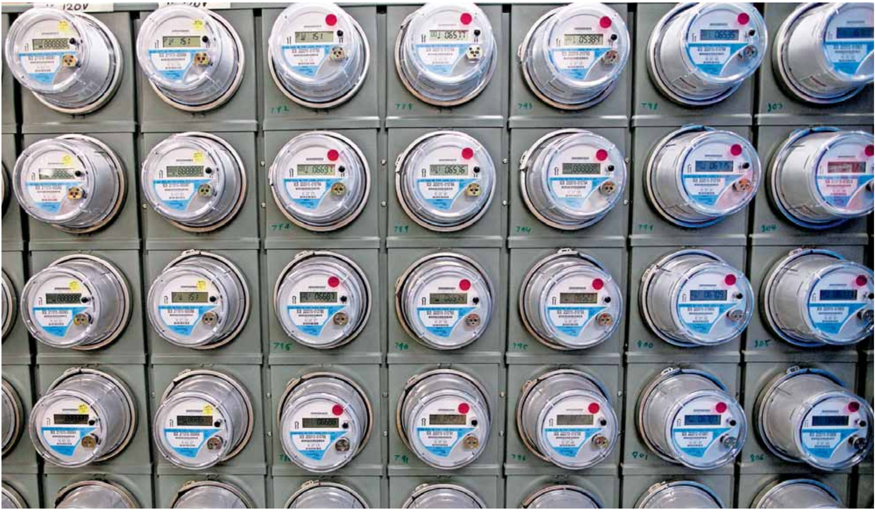
Sogenannte Smart Meter erfassen den Stromverbrauch eines Haushalts digital. Verbraucher können damit am PC oder Smartphone nicht nur ihre Energiebilanzen ablesen, sondern Haushaltsgeräte dann in Betrieb nehmen, wenn besonders viel Strom im Netz ist. FOTO: BLOOMBERG
